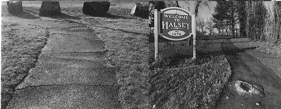
Uneven asphalt pavement.
